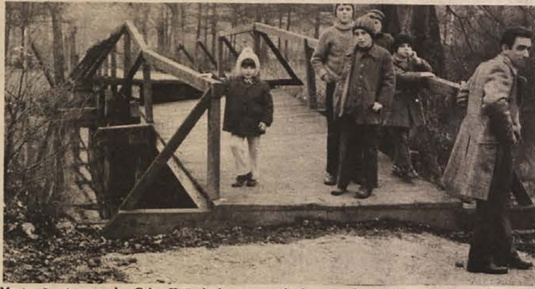
Most v športnem parku Gaj v Kočevju je resno poškodovan, malo zaradi poplave, še več pa zaradi objestnežev. Je že nevaren, predvsem za otroke, zato ga je treba čimprej popraviti. (Foto: J. Primc)
