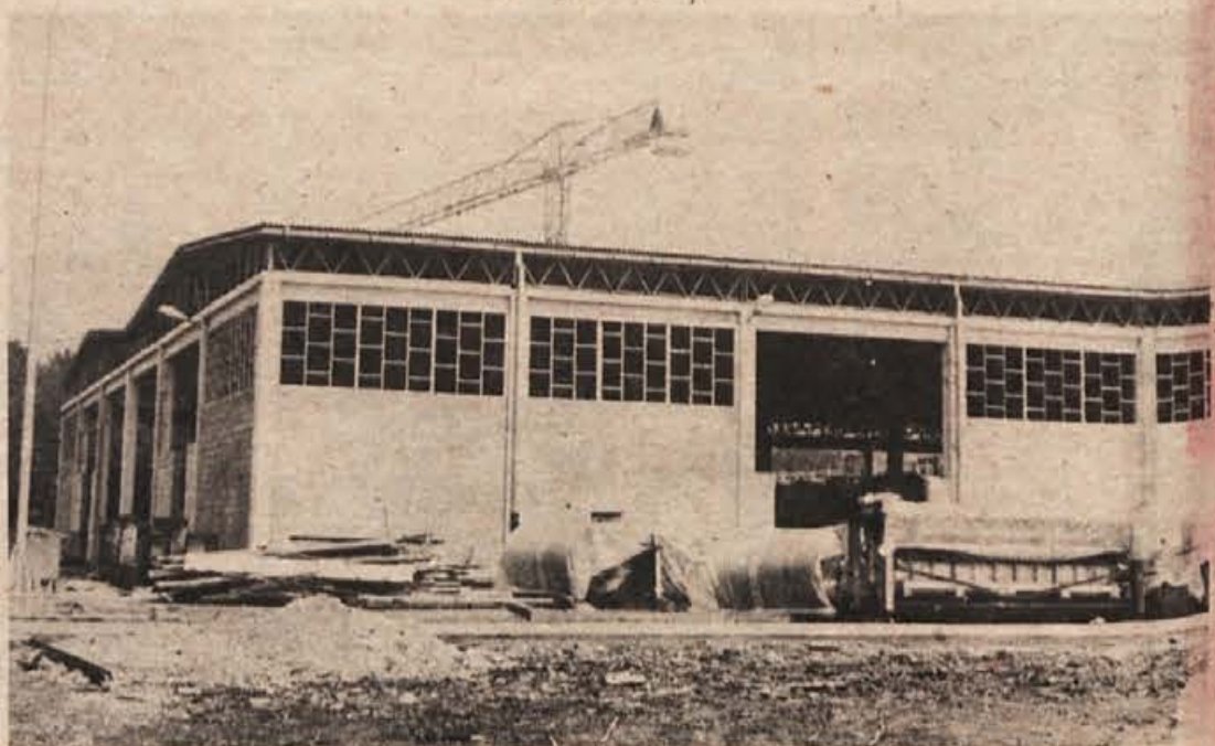
Skadišče za star papir je pod streho. Sedaj imajo v njem uskladiščene dele novega papirnega stroja, ki so ga kupili v Angliji.
