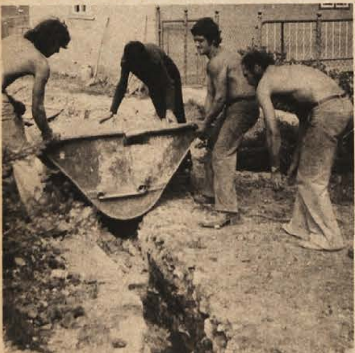
Minerci imajo pri gradnji vodovoda v Grčaricah precej dela, saj potekajo jarke pretežno po skalnatem svetu.
