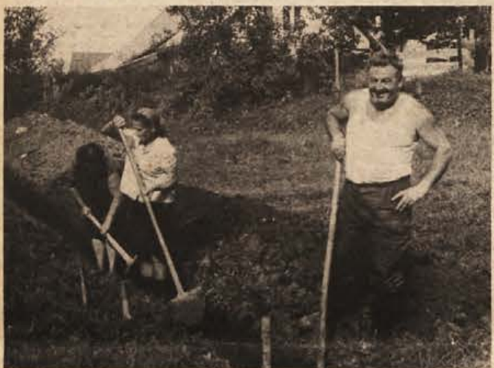
Grčevljani so z veseljem kopali jarke za vodovodne cevi, ker so se zavedali, da bo potem vse lažje, ko bodo imeli pitno vodo v hiši.
