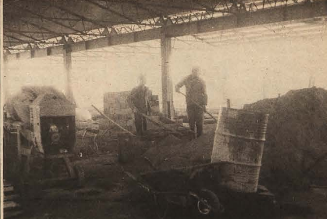
Delavci „Trima“ so postavili streho nad novim obratom „Novoteksa“. Do konca letošnjega leta pa naj bi bila gradnja končana. (Foto: B. Podobnik)
