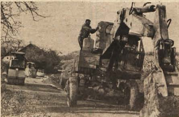
TUDI V MIRNI PEČI ASFALT - Gradbeni stroji novomeškega Cestnega podjetja že več dni pripravljajo za asfaltiranje cesto od Mirne pa čič do Biške vasi. Posnetek kaže delo na cesti v Biški vasi, kjer so se najprej začele priprave. (Foto: Polde Pungercar)
