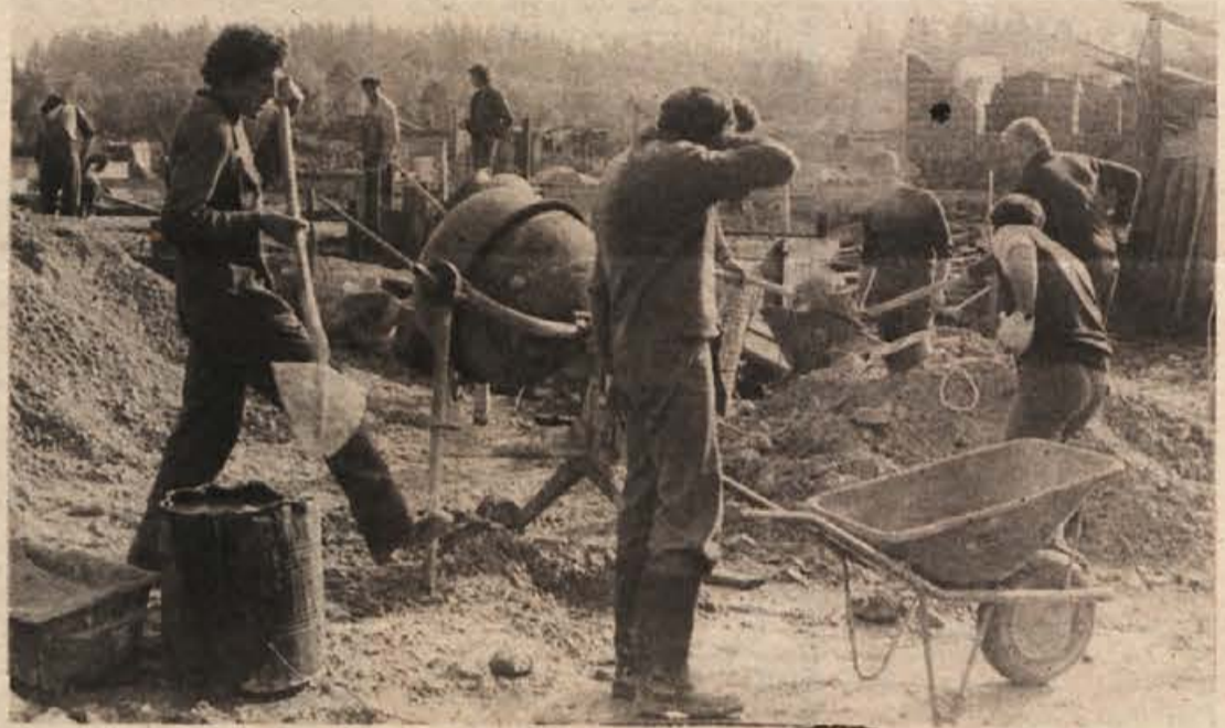
Trenutno največje gradbišče v Kočevju - zadrzna gradnja v Mestnem logu. (Foto: F. Brus)
