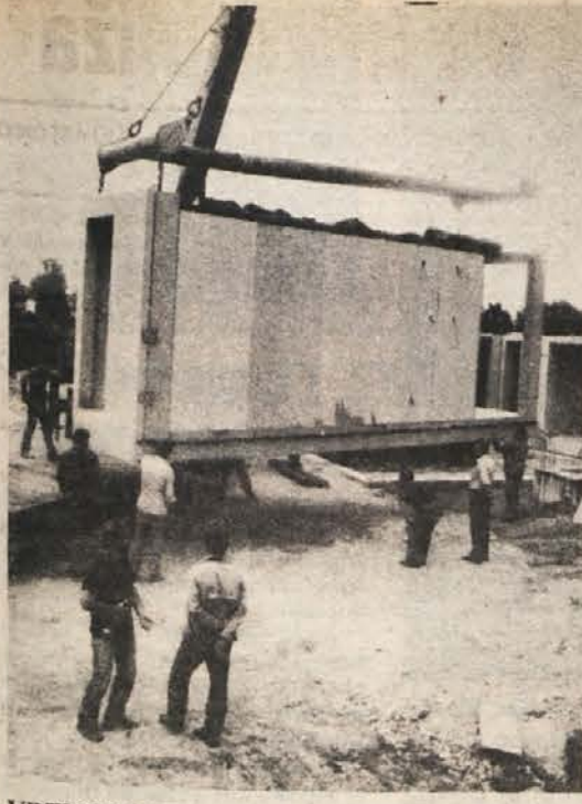
VRTEC PRIPELJALI S KAMIONI – Minuli teden je 30 težkih tovornjakov – priklopnikov pripeljalo v Kočevje montažne celice in druge elemente za novi montažni vrtec Čebelica. Vrtec so sproti sestavljali, pri čemer so sodelovale ekipe tozgov Vegrad iz Velenja. (Foto: J. Primc)
