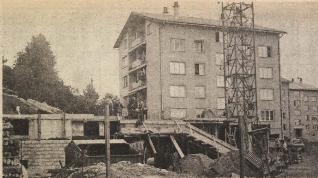
BLOK IN TRGOVINA NA MESTNIH NJIVAH – Novi poslovno-stanovanjski objekt med 4. in 5. blokom na Mestnih njivah že raste iz tal. V novi stavbi, ki bo julija prihodnje leto dograjena, bo 16 stanovanj, od teh 11 trosobnih, 3 dvosobna in 2 enosobni. Razen tega pa bo v pritličju 100 m 2 površine namenjene trgovini. (Foto: R. Bačer)
