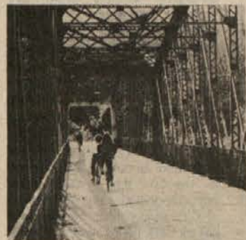
MOSTOVA ČAKATA NA OBNOVO — Dolga desetletja sta mostova čez Krko in Savo v Brežicah služila svojemu namenu, zdaj čakata na pre-potrebno obnovo, ki bo stala poldrugo milijardo dinarjev.
