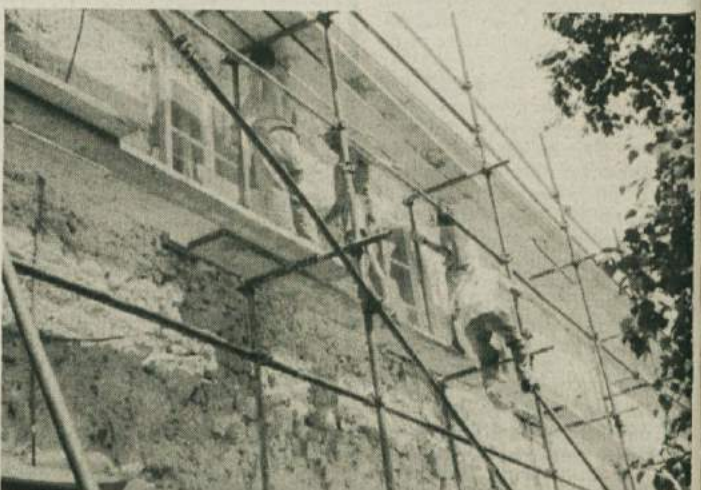
DEL GRADU KAŽE REBRA - Hkrati z ustavitvijo poljenja južnega grajskega vogala bodo obnovili tudi fasado na južnem krilu metliškega gradu. Zato morajo zidari najprej odbiti staro fasado, pod katero so se prikazala zanimiva odkritja. (Foto: M.B.-J.)
