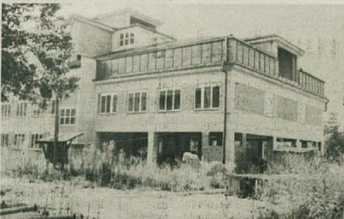
GRADBIŠČE NOVE NOVOMEŠKE BOLNIŠNICE - Če bo vse po sreči, naj bi bil do spomladi dokončan del, v katerega bodo preselili oddelke, ki so sedaj na levem bregu Krke. (Foto: J. Božič)
