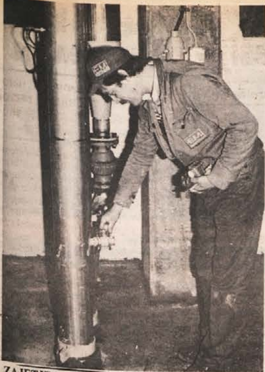
ZAJETJE LUGA – V tovarni Djuro Salaj v Krškem potekajo redna vzdrževalna dela, hkrati pa postopno priključujejo čistilne naprave. V tozdu Celuloza vključujejo napravo za zajemanje luga. Na sliki: delovodja mariborske Hidromontaže Andrej Domadenik namešča ventil za jemanje vzorcev. (Foto: P. Perc)
