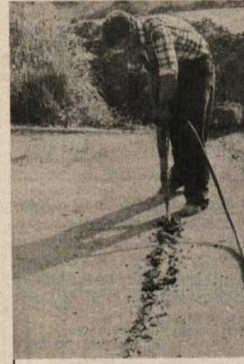
METLIŠKA TELEFONIJA — V zadnjih dveh letih so prekopalji tako rekoč vso metliško občino. Do konca poletja bodo zaključili
