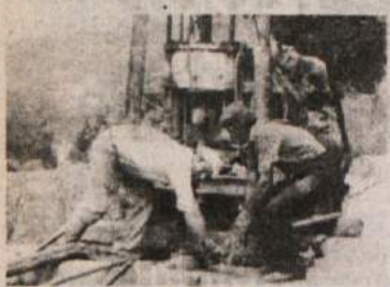
PLAZOVI — Delavci ljubljanskega Geološkega zavoda so ob cesti Orehovo — Breg zvrtili več vrtn, da bi ugotovili nevarnosti plazanja zemljišča proti magistralni železniški progi oz. Savi.
