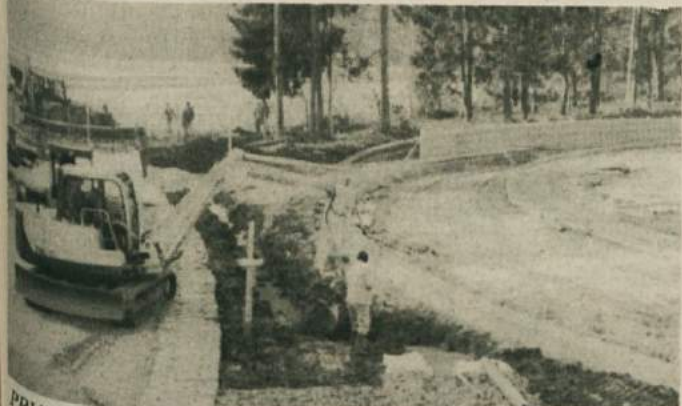
PRVI OBRISI VELODROMA - Graditeljem gre za ta čas lepo vreme kar na roke in velodrom v Češči vasi že dobiva obris za tovrstne gradnje značilnega ovala. Prejšnji teden so se delvacem Gradisa in novomeškega Vodnogospodarskega podjetja z lopatami v rokah pridružili tudi člani gredbenega in organizacijskega odbora z Lojzom Peterletom, Francem Goletom in Francijem Koncilijo na čelu. Če bo graditeljem vreme še naprej tako dobro služilo, bodo do božiča opravili vsa betonska in inštalacijska dela.
